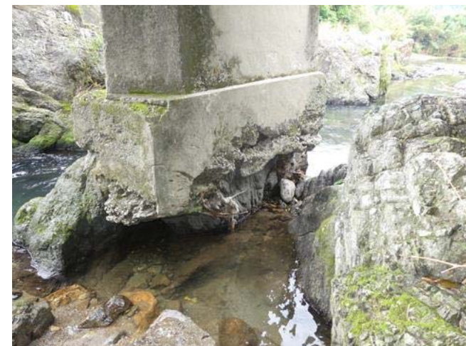
地方自治体管理 橋脚洗掘
