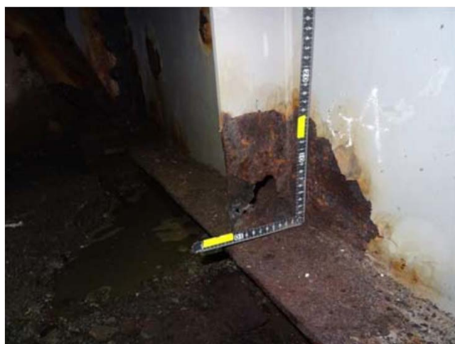
国管理 主桁腐食・欠損
