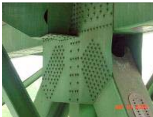
板厚不足とされたガセット
