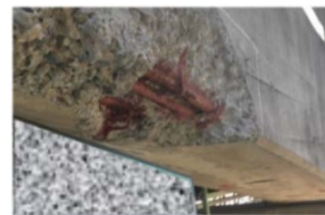
損傷状況（鉄筋露出）
