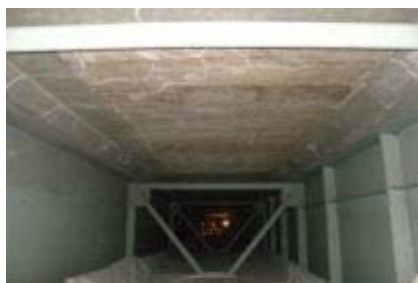
ひび割れの発生
