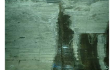
損傷状況（うき・漏水）
