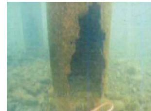
▲ 橋脚水中部の断面欠損
