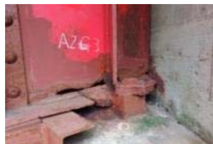
桁端部の腐食・貫通
