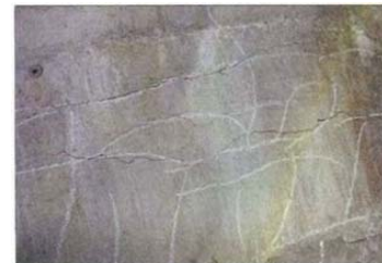
下部工（柱頭部）にASRによる劣化が疑われる
