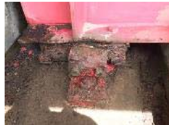
地方自治体管理 支承腐食
