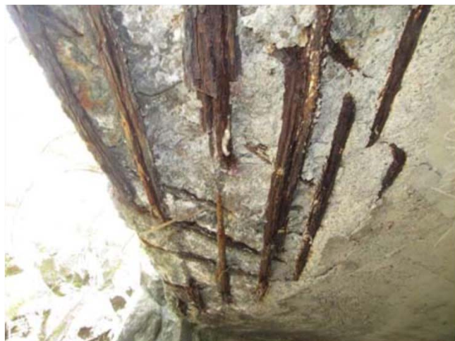
国管理 床版鉄筋露出 ※床版：橋の裏側
