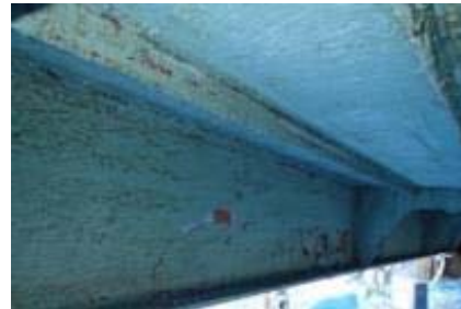
桁の塗装劣化やさびの発生
