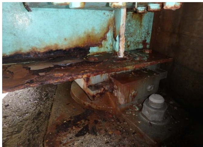
地方自治体管理 主桁腐食
