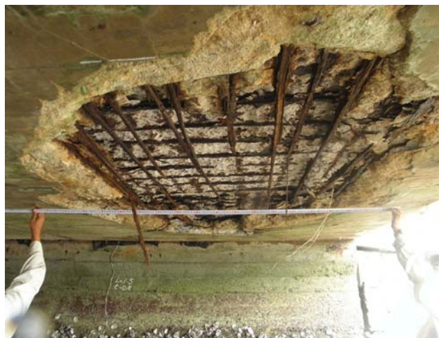
地方自治体管理 床版鉄筋露出
