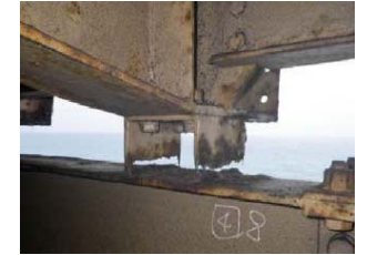
▲ シェッド主梁端部破断
