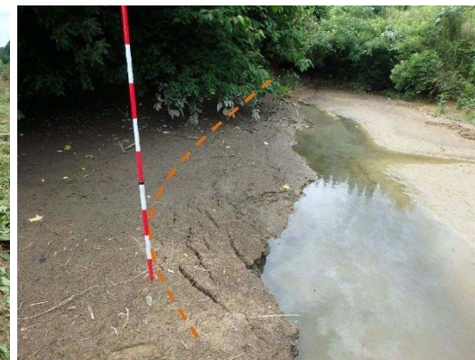
⑤ ため池内の亀裂
