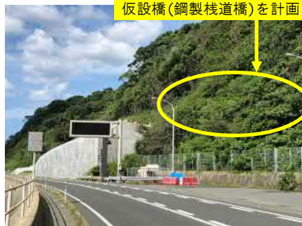
写真-2 計画された仮設橋 (鋼製栈道橋)は未施工 (2021.8.19撮影)
