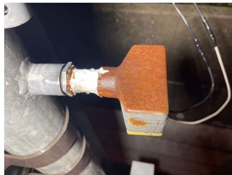
配線部分の腐食
