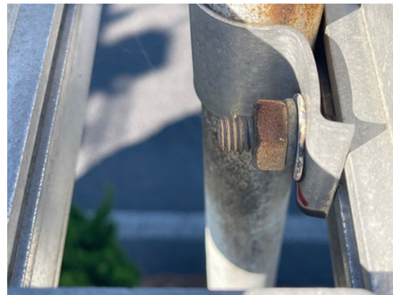
標識板取付部の腐食
